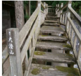
老朽化している階段
