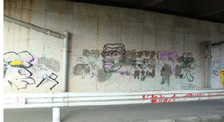
睦橋の橋脚のいたずら書き
